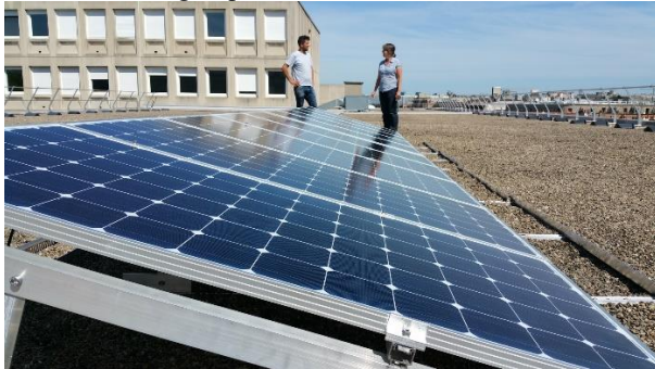
Figure 67 : champ PV du département GIM installée sur une toiture terrasse de l'IUT de Saint-Denis (2kWc - stockage - gestion de l'énergie par un onduleur intelligent IMEON 3.6 d'Imeon Energy xxxvi )
